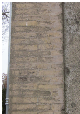
[ph. 16] Buzet (31) Chaînage en briques.- MV
